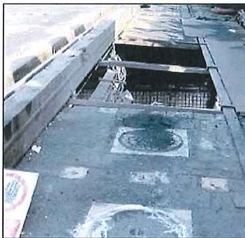
L'area delle cokerie-Ilva in cui si verificò l'incidente mortale
